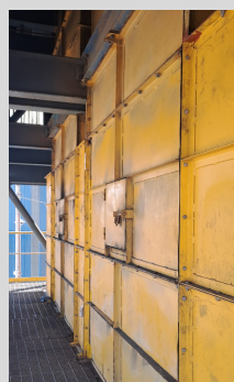
Modificación de tapas de contrapeso en las torres de transferencia Cerro Verde - TISUR
